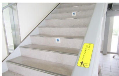
【川崎】ヒヤリハット報告内容の対策事例② R&D センター階段手すりへの“手すり持ち”表示
