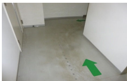
【川崎】ヒヤリハット報告内容の対策事例① 衝突危険箇所への右側通行表示
